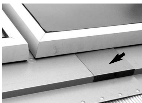
Fijación de las chapas de plomo estirada hacia atrás y colocada en su sitio
